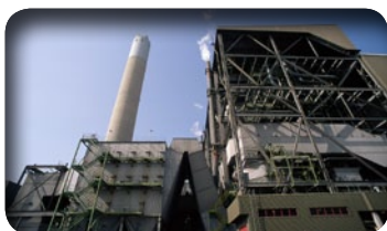
青山發電廠的靜電除塵器
