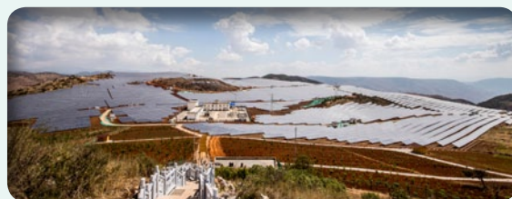
中國雲南西村光伏電站
